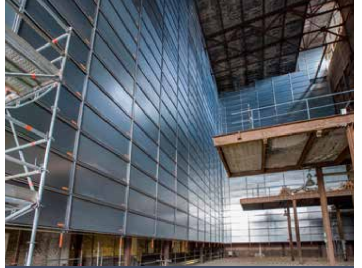
Bir elektrik santralindeki bakım çalışmaları için Koruma Sistemi
