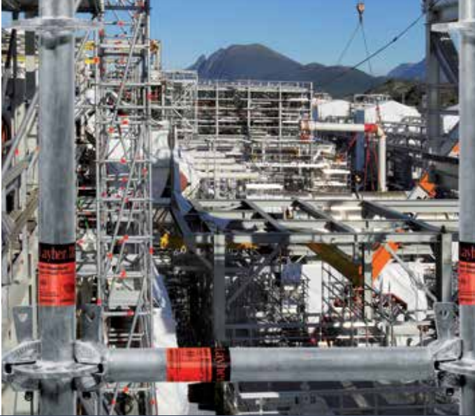
Sıvılaştırılmış gaz tesisi, Norveç
