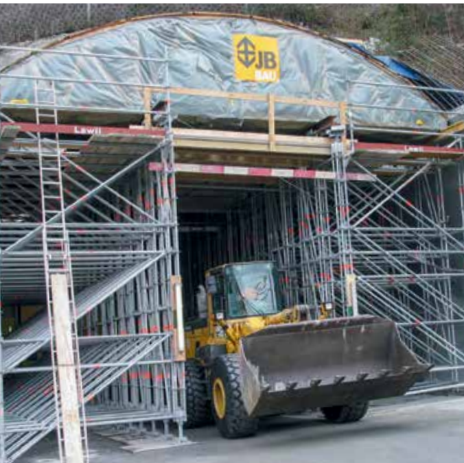
Birleşik dikmeler ve araçlar için bir geçiş açıklığı ile Allround İskele kullanılarak yapılan Allround TG 60 Taşıyıcı İskele
